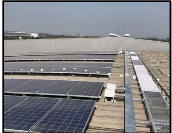
Lotus Wangnoi, ขนาดติดตั้ง 900 kWp.
