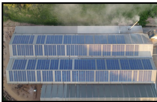
Woodwork Advance Branch ( Songkhla Province ), ขนาดติดตั้ง 997 kWp.
