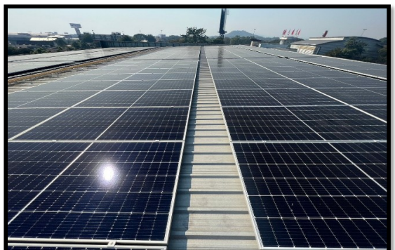
Kasemrad Hospital Sriburin ( Chengrai Province ), ขนาดติดตั้ง 407 kWp.
