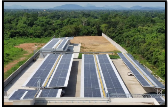
Kasemrad International Aranyaprathet, ขนาดติดตั้ง 730 kWp.
