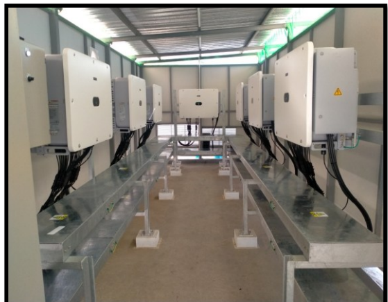
Kasemrad International Hospital Aranyaprathet, ขนาดติดตั้ง 730 kWp.
