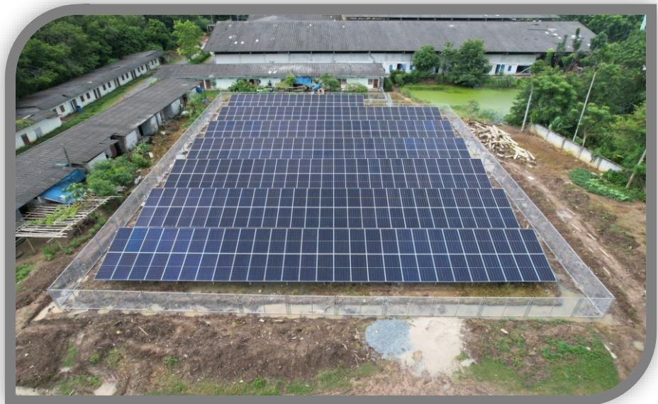
Woodwork Kapang Branch (Nakhon Si Thammarat Province) ขนาดติดตั้ง 225 kWp.
