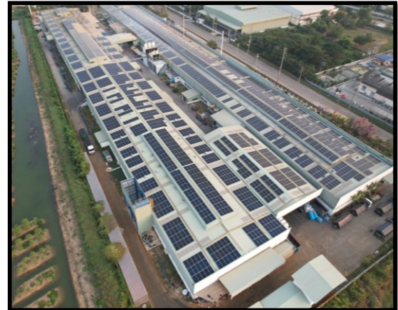
Rajratan Thai Wire, ขนาดติดตั้ง 1,766 kWp.
