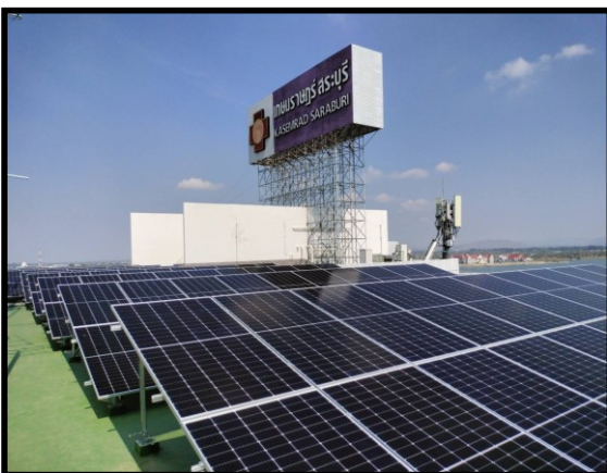
Kasemrad Hospital Saraburi, ขนาดติดตั้ง 307 kWp
