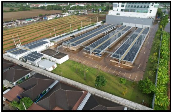
Kasemrad Prachinburi, ขนาดติดตั้ง 545 kWp.
